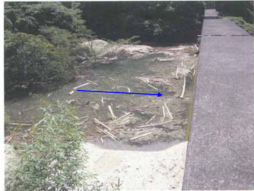
堰堤内の流木
