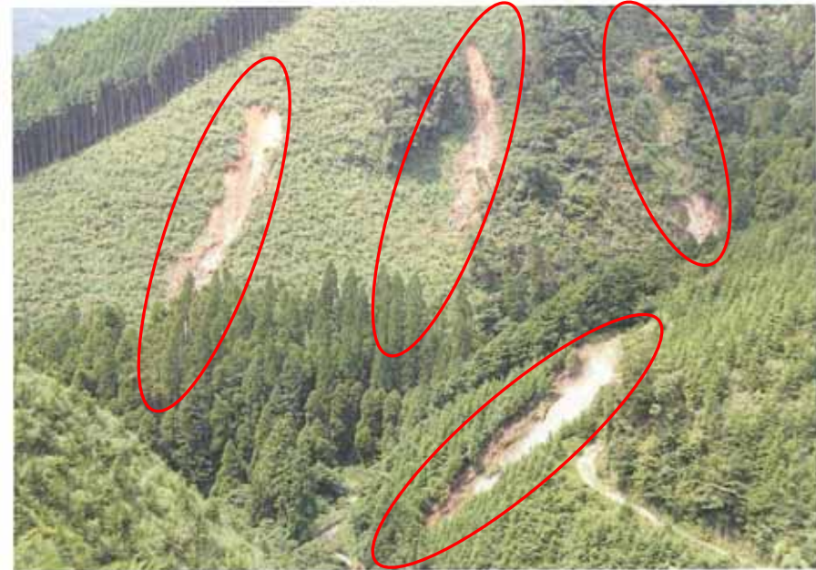
砂防上流の山腹崩壊の状況
