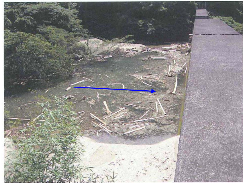
堰堤内の流木
