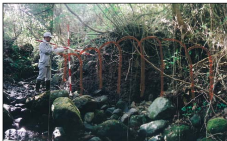
【整備前】 溪岸侵食・濁水の状況
