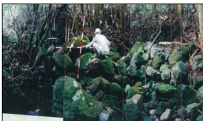
【整備前】 不安定な土石の堆積状況
