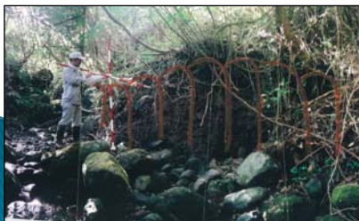
溪岸侵食の状況
