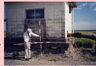
地盤沈下による抜上り
