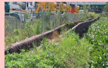
地盤沈下による水路の不陸
