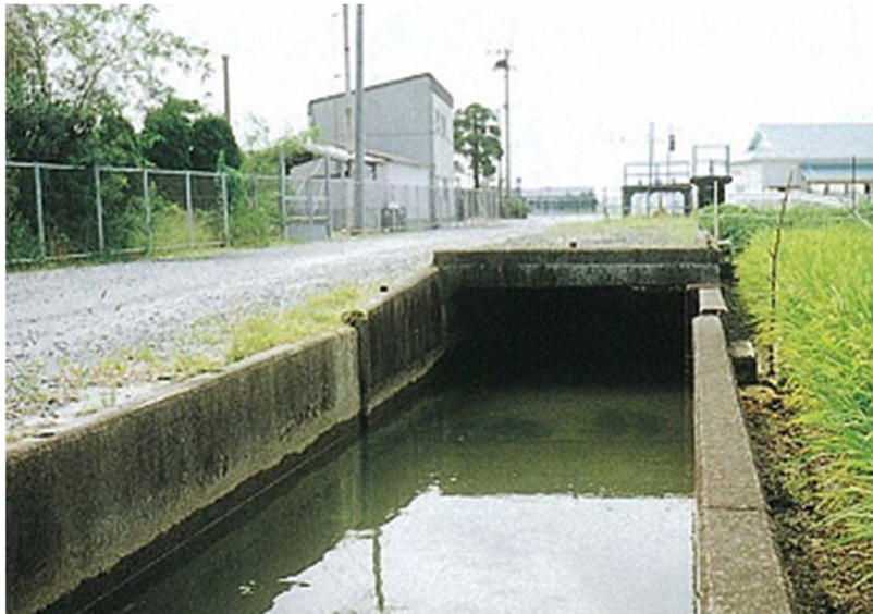
段差とズレが生じている状況 (大井手幹線水路)
