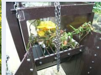
ゴミ詰まり状況
