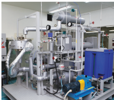
(株)ミゾタ内プラントの加圧熱水処理装置
