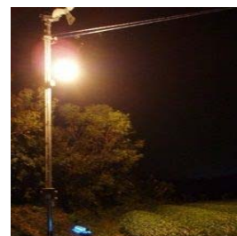
図 黄色灯の設置状況
