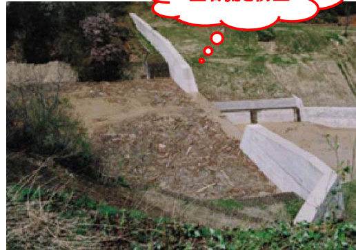
土石流発生後
