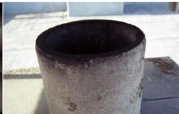
煙突の内側に使用 石綿含有断熱材
