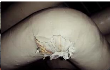
エルボ部に使用 石綿含有保温材
