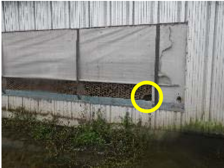
家きん舎側面の金網の破損
