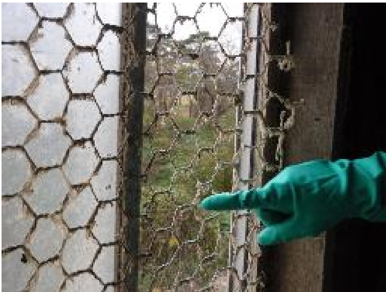
家きん舎側面の金網(所々にホコリがついておらず、 動物が通過していると考えられるマス目あり)
