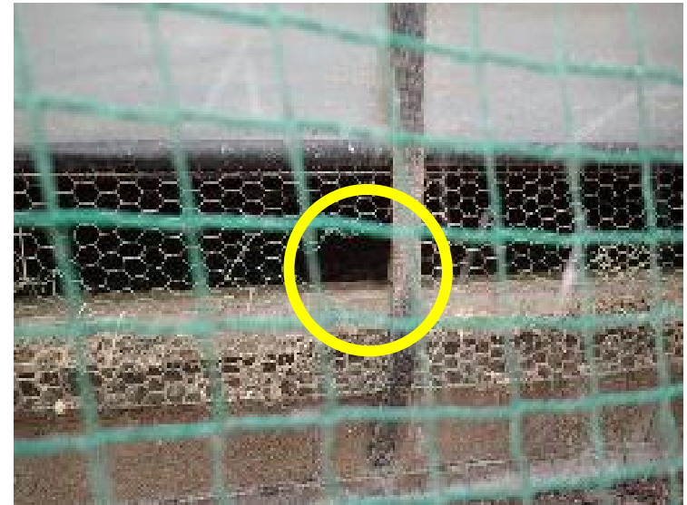
家きん舎側面の金網の破損 (手前は防鳥ネットを設置)
