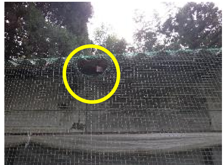
家きん舎側面の 防鳥ネットの破損
