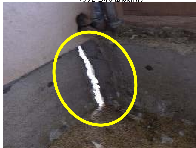
家きん舎の基礎部分にヒビ割れ
