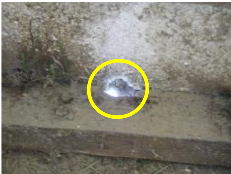
家きん舎の壁が一部破損し、 床との間に隙間
