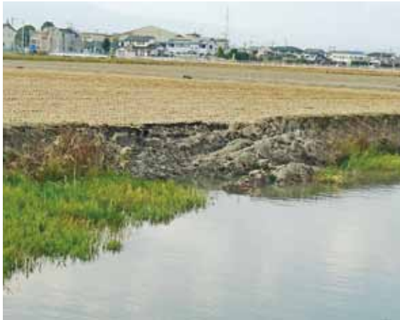
法面が崩落し、洪水調整機能が低下
