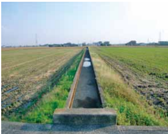
地盤沈下により用水路の機能が低下
