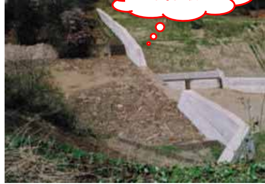
土石流発生後
