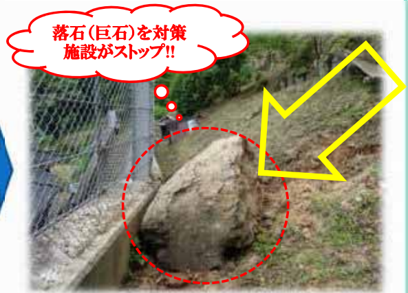
落石発生後（近景）
