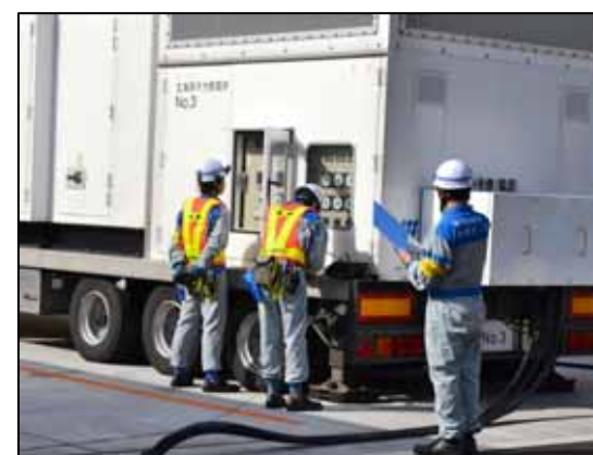
大容量空冷式発電機車の起動
