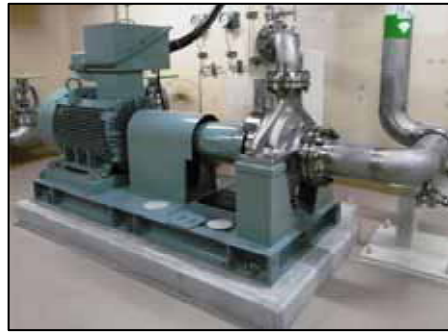
常設電動注入ポンプ
