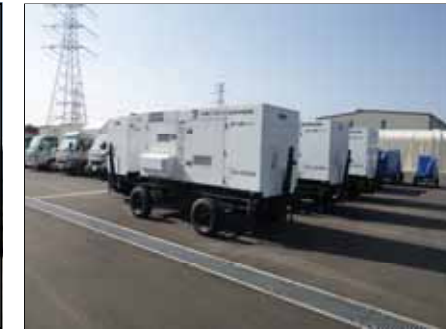
直流電源用発電機
