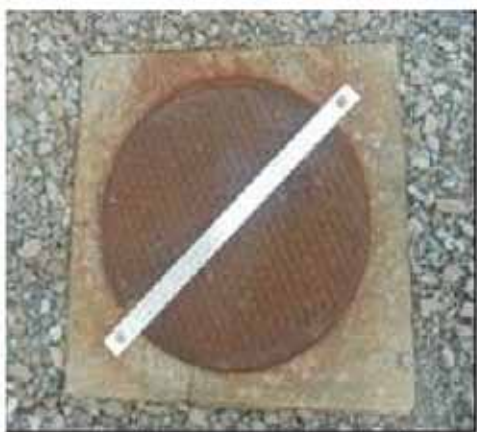
(1)マンホールふた
