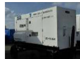
直流電源用発電機
