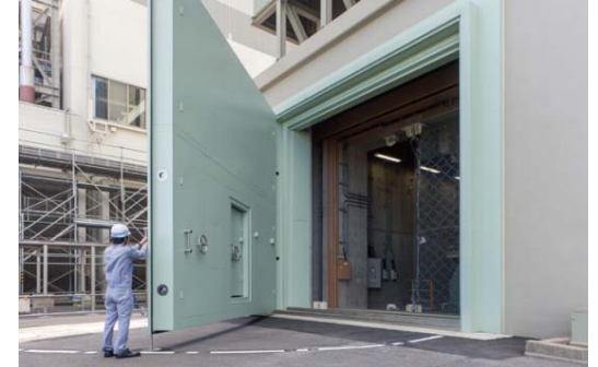
【水密扉(玄海原子力発電所)】
