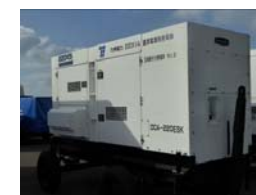
直流電源用発電機
