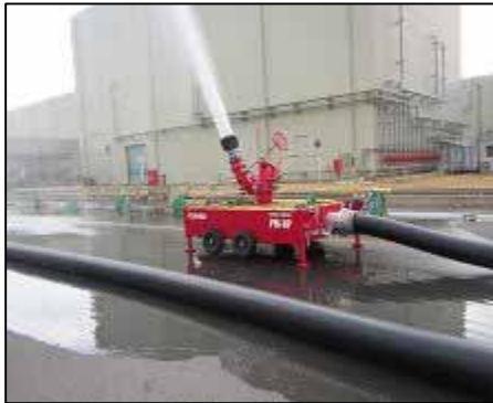
放水砲の設置
