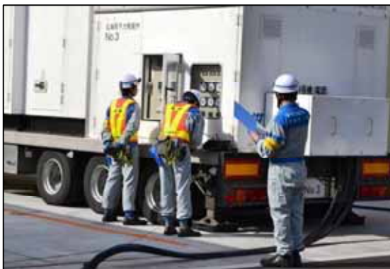
高圧発電機車によって電力を供給する訓練
