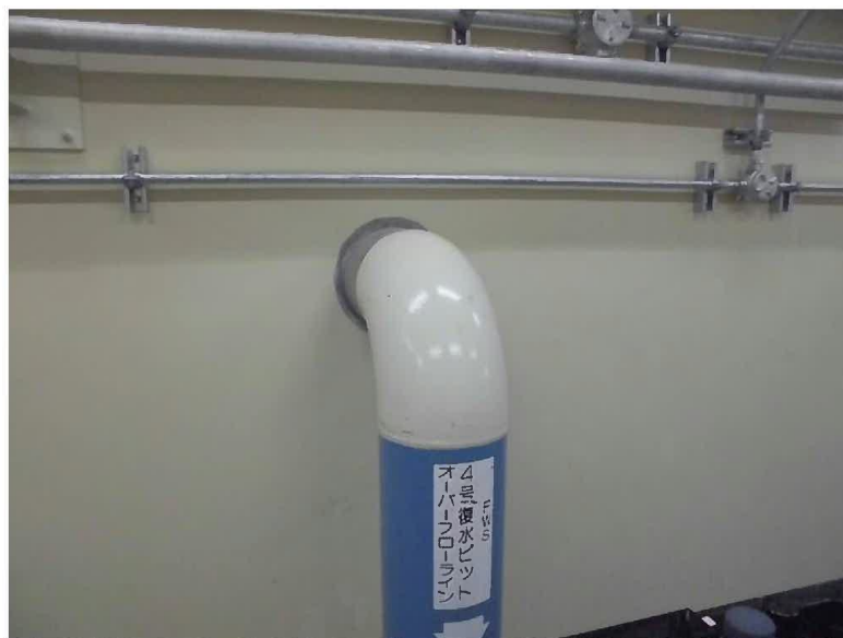
復水ピット点検
