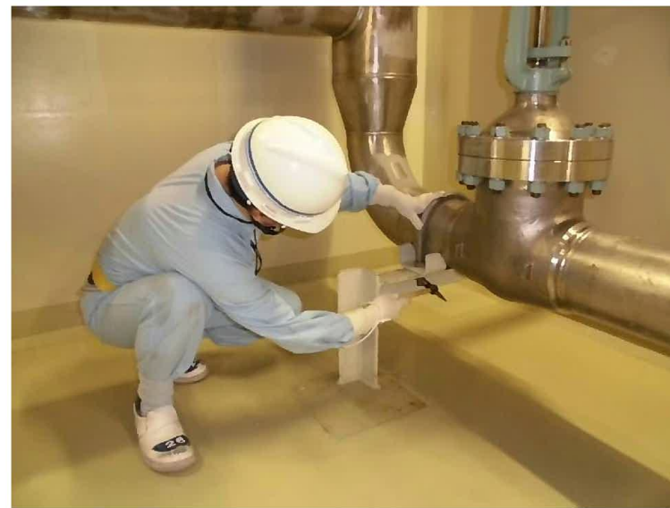
支持装置点検
