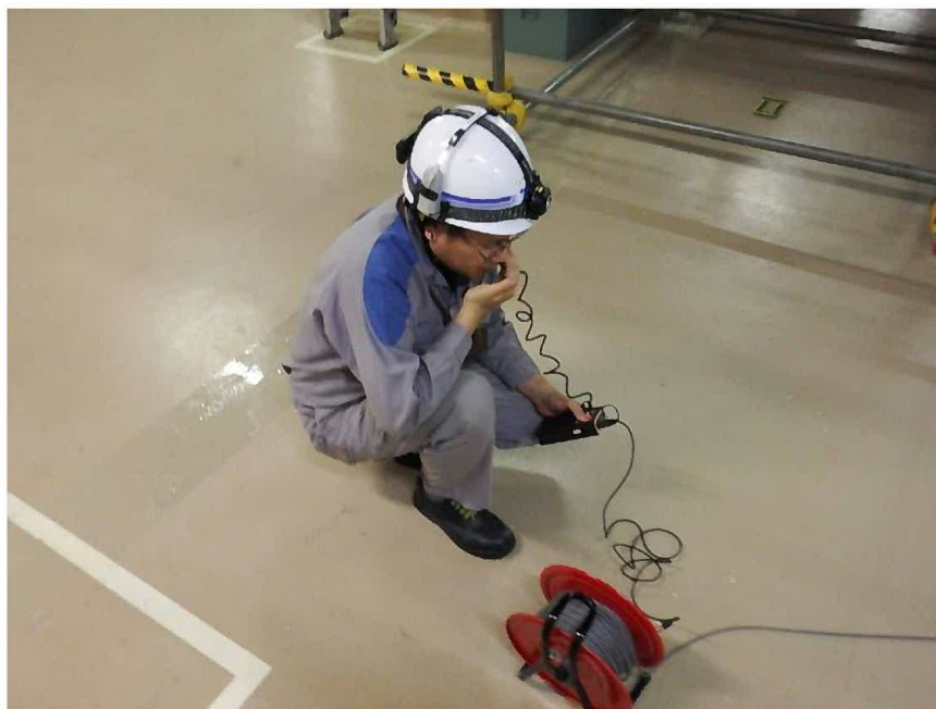
通信機器点検(通話装置)
