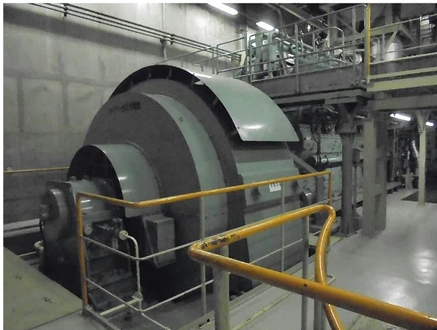
非常用ディーゼル発電機作動試験
