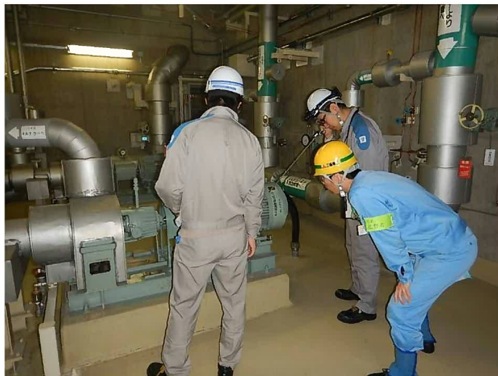
運転中機器の点検
