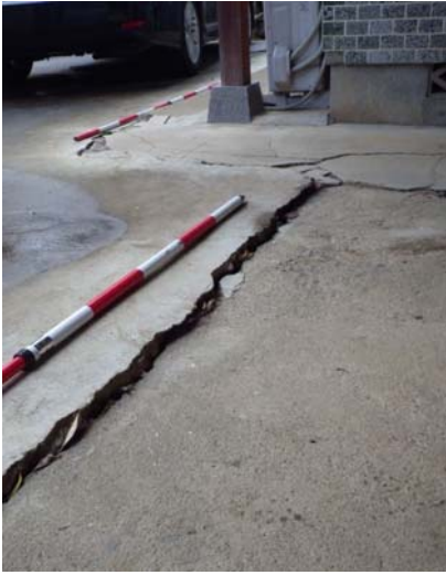
宅地内の亀裂・段差発生
