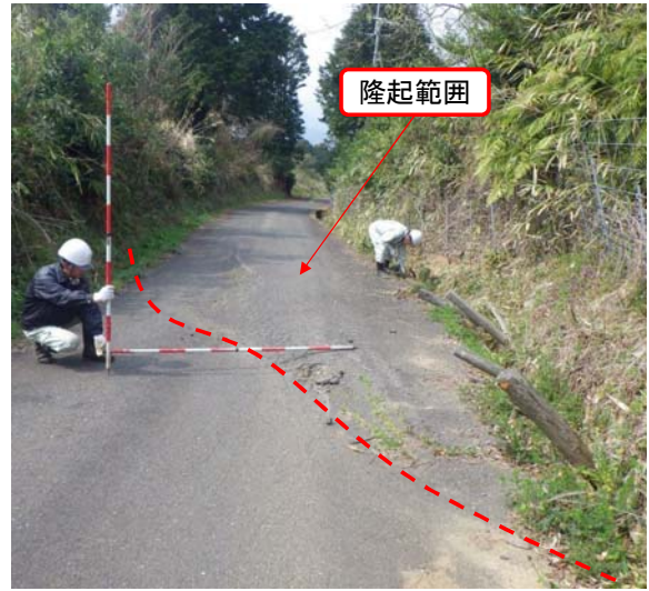
隆起により市道の亀裂・段差発生
