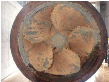
インペラ腐食状況（ポンプ内）
