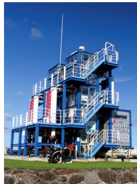
【久米島町:海洋温度差発電実証試験施設】
