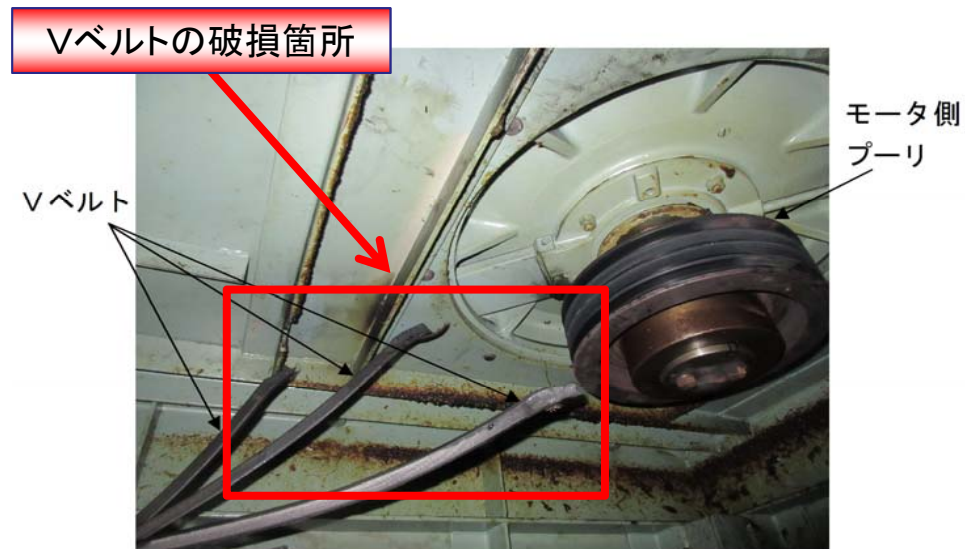
＜Vベルトの破損箇所＞
