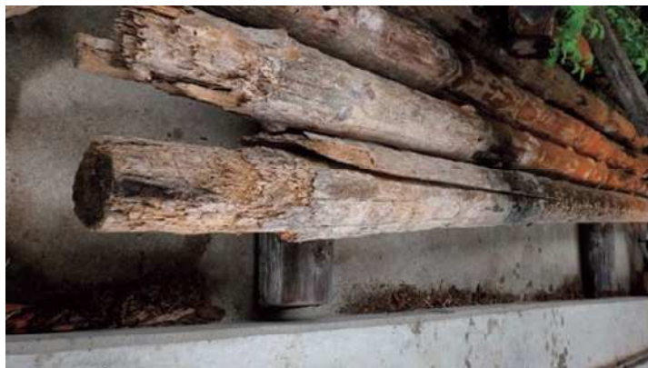
写真－5 貫通割れが発生した木杭
