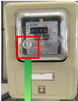
電気メーター (有効期限 5, 7, 10 年)
