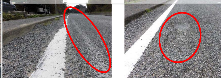
排水性舗装の劣化(轍掘れ、路面の凹み)
