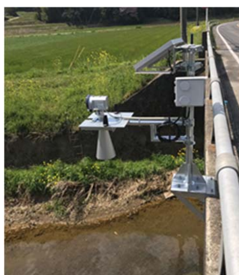
写真 6.4 河川水位情報の提供（水位計）
