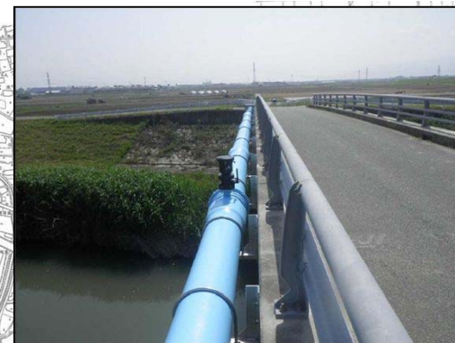
水管橋（橋梁に添架）
