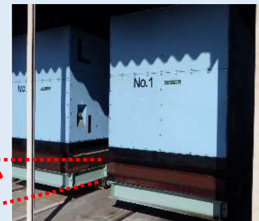
西今宿排水機場（佐賀市）
