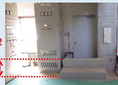
納所排水機場（多久市）
