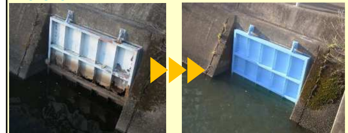
フラップゲートにおける活用事例
