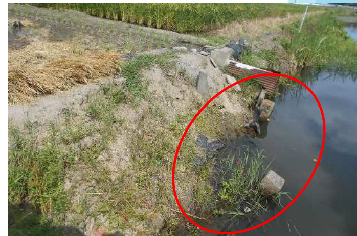
現状（コンクリート杭柵が崩壊）
