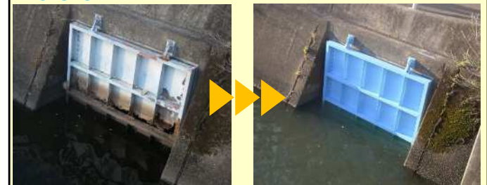
フラップゲートにおける活用事例
