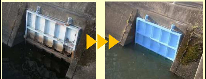
フラップゲートにおける活用事例
