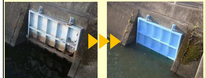
フラップゲートにおける活用事例
