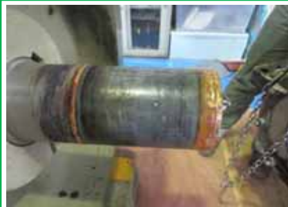
排水ポンプ（軸受部）の老朽化
