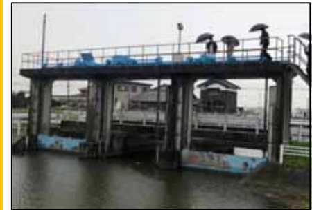
老朽化した水門は開閉操作が困難
