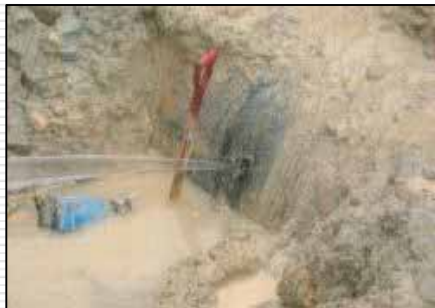
老朽化したパイプラインの漏水状況
