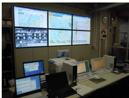
テレメータ中央監視局（環境センター）
