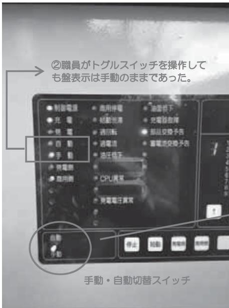
非常用発電機操作パネル
