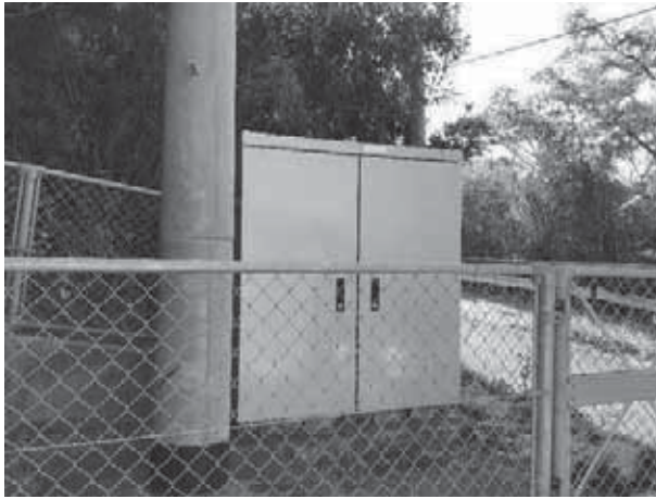
串局非常用発電機外観
