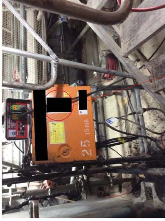
仮設電源盤・降圧トランス (遠景)
