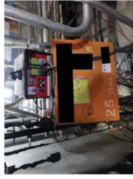
仮設電源盤・降圧トランス
