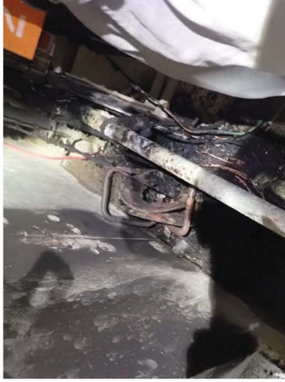
焼損した電工ドラム、半断線したケーブルA
