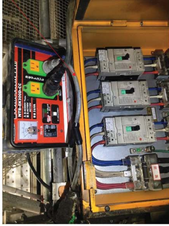
仮設電源盤・降圧トランス (近景)
