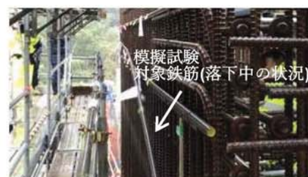
段取筋フックから落下させた後の状態 （全ての結束線が断線し、落下）
