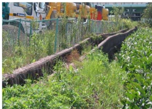
凹凸が生じている状況 (三日月南部線)
