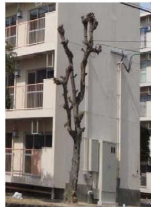
電気幹線改修（改善後）
