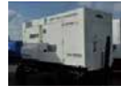
直流電源用発電機
