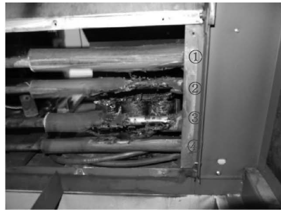
変圧器（背面）と冷媒配管（保温材）
