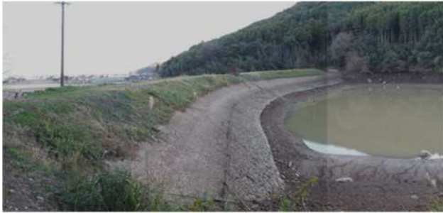
整備前（堤体の老朽化が進行） 【白石町 坂田地区】
