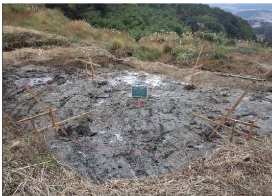
整備前（集水井設置前状況・湧水が多い） 【武雄市 船ノ原第2地区】
