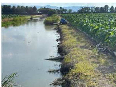
法面崩壊状況【白石町 白石地区】
