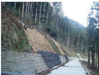
角の内線開設状況(整備中)
