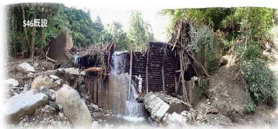
（治山施設【バットレス】被災（小城市））
