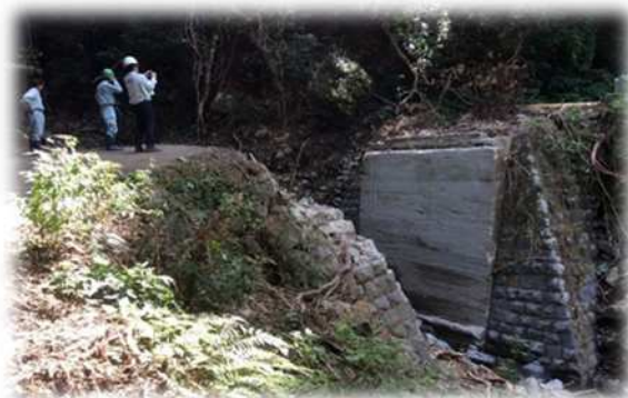
（林道 岸川支線（多久市）橋梁倒壊）
