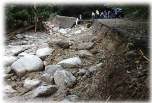
（土石流による林道（金立山線）被災）
