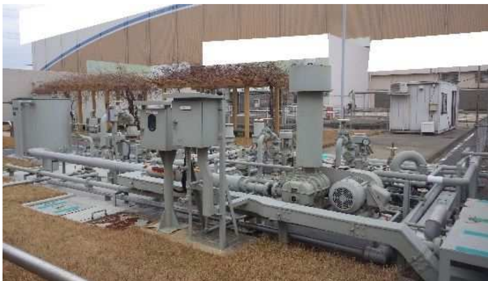
復水脱塩装置(中和槽・排水槽排水設備)
