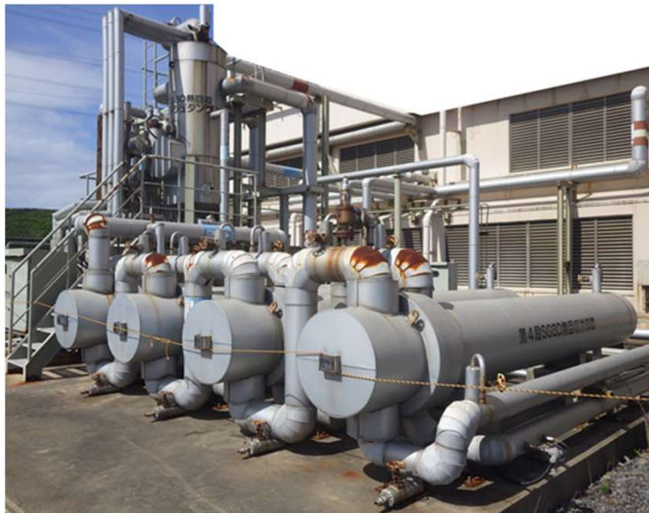
SGBD熱回収装置
