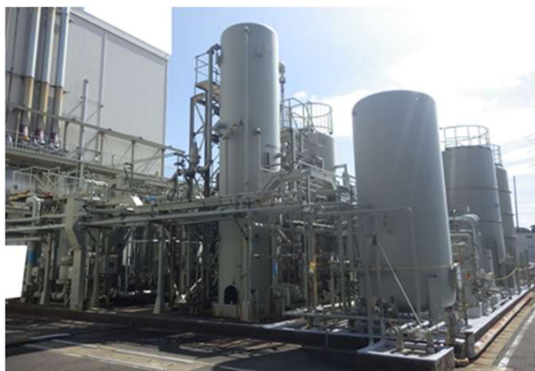
復水脱塩装置 (中和槽・排水槽排水設備含む)
