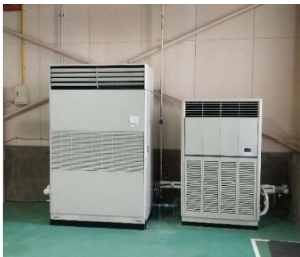
機械実習棟の室内機 (大小2台併置)
